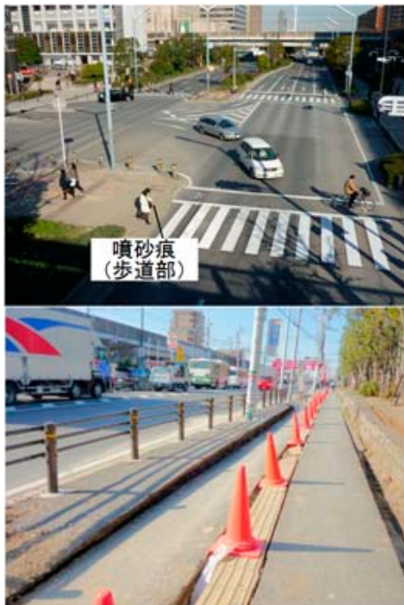
写真-1 車道と歩道の液状化被害の差
