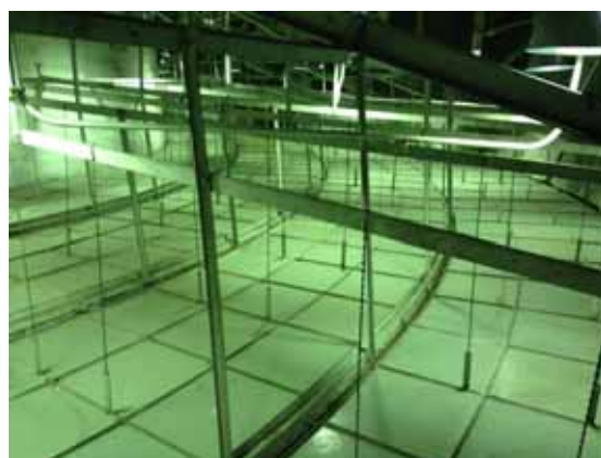
写真 - 3 改修前の天井下地の状況
