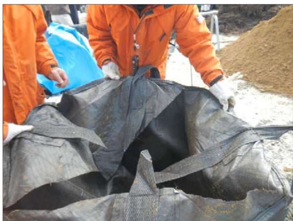
写真-2 大型土のう袋の破袋状況
