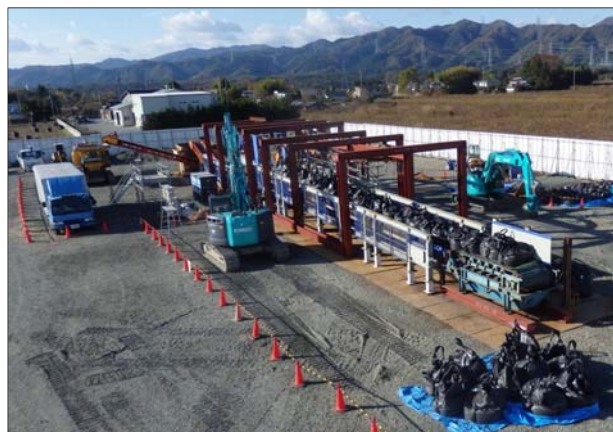
写真-3 平成26年度技術実証の設備全景
