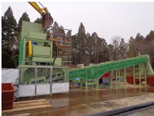
写真-13 実証試験機の全景
