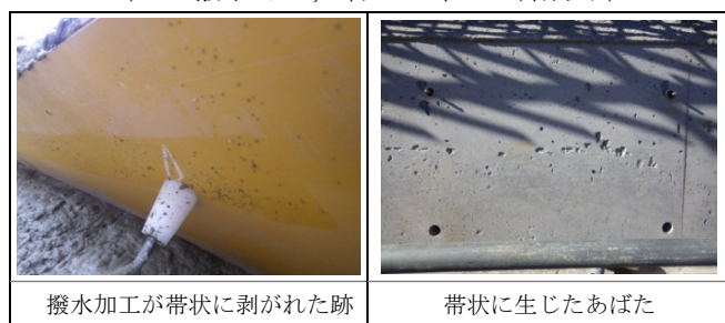
写真-22 撥水加工の剥がれとその部分の仕上がり
