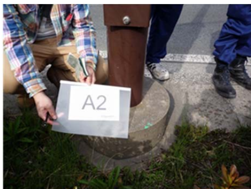
写真-1 測点 A2: 街灯の基礎
