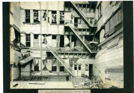
写真-5 東京会館被害 (内部)
