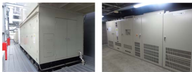
(a) ガスエンジン発電機
