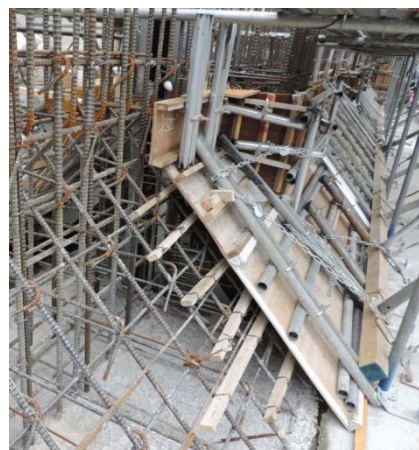
写真-1 壁部材下部のハンチ部分の状況
