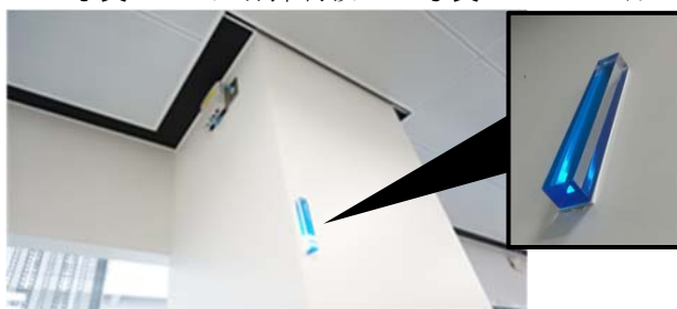
写真-4 自然換気有効表示灯
