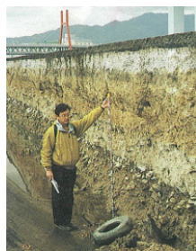
(b) 護岸背面地盤の沈下
