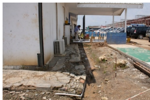
写真-3 膨張性地盤の影響によるひび割れ
