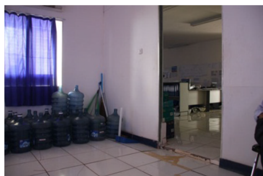
写真-2 膨張性地盤の影響による段差
