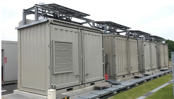
写真-1 構築した水素エネルギー利用システム
