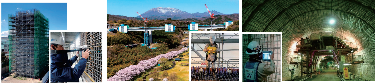
写真-15 検査状況(左:川崎臨港下部、中央:船谷川橋、右:音中トンネル)
