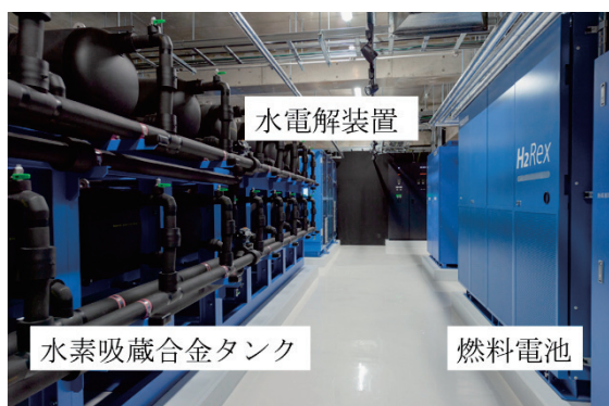
図-8 北陸支店内「Hydro Q-BiC®」
